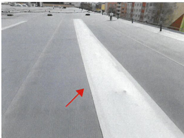
foto /14/ Pohled na lokální záplatu z přířezu střešní fólie
