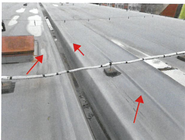
foto /24/ Pohled na odtokový žlab v ploše střechy a patrnou tvorbu vrás
