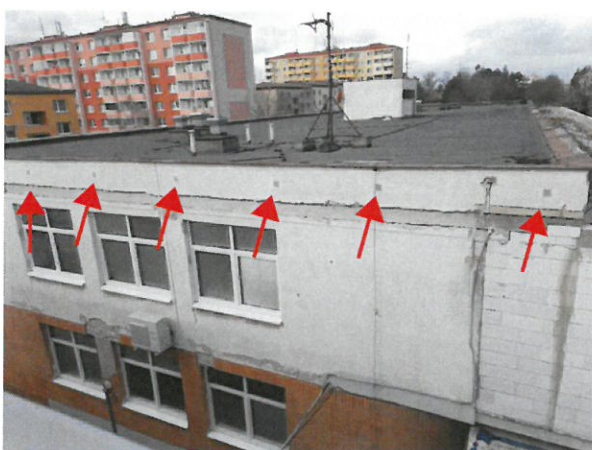
foto /36/ Odvětrávací průduchy na atice sousední administrativní budovy sloužící k odvětrávání spádové vrstvy z keramzitu.
